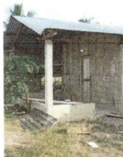
Foto 3: Las paredes de la cocina presentan moho, lo cual representa un riesgo para la salud.
